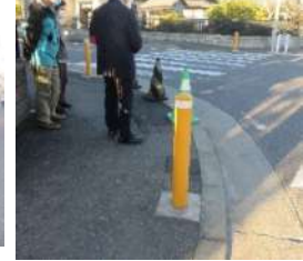
ガード破損場所
